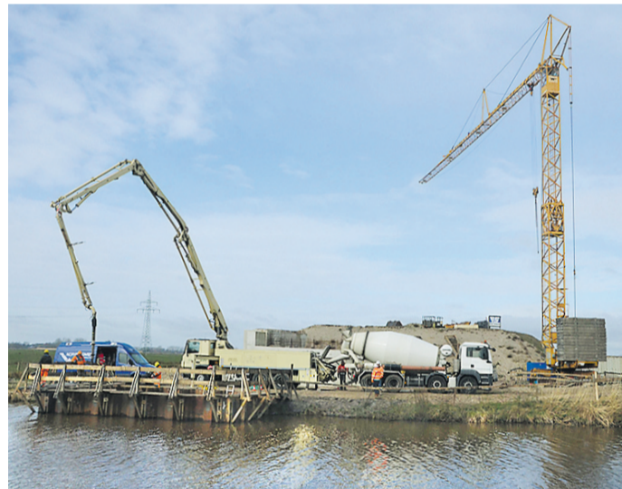
Hier entsteht eine Brücke der Bundesstraße 212 neu über den Motzener Kanal. BILD: GABRIELE BODE
